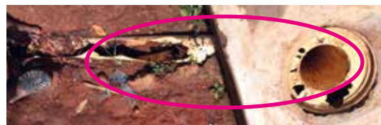
Figure 3 – Conduite brisée non immergée, donc non conforme au cahier des charges
