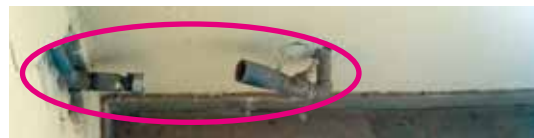
Figure 2 – Les conduites d'eau n'étaient pas raccordées
